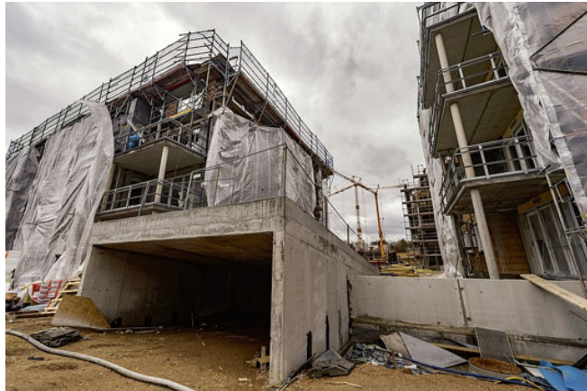
Neubau auf Kasernengelände: »Dumm und dämlich verdient«
